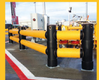
Atlas Barrière Traffic Double protégeant un mât d'éclairage de piste d'aéroport.
