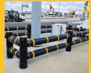
Atlas Barrière Traffic Double avec bandes réfléchissantes protégeant un mât et une unité électrique dans un aéroport.
