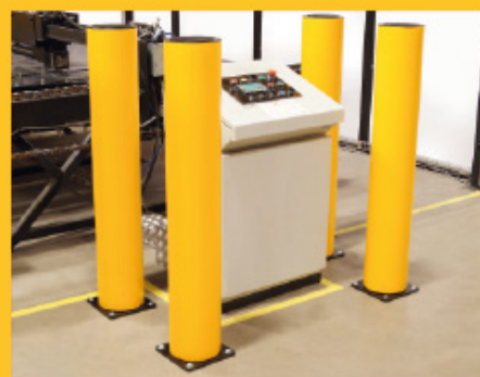
Beschermipalen beschermen bedieningspanelen voor semiautomatische machines in fabrieken.
