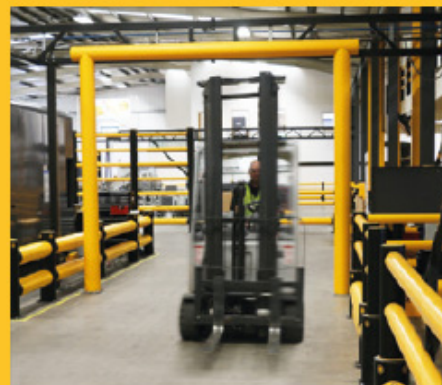
Hoogtebegrenzing beschermt de elektriciteitskabels in een productieomgeving.
